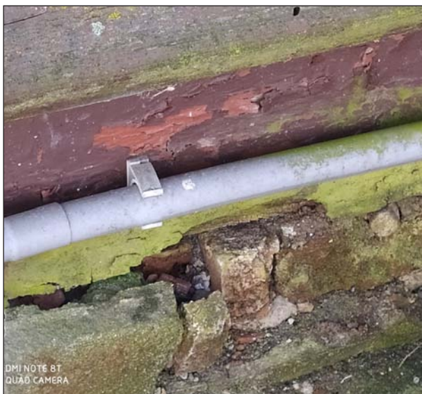
➤ Zdegradowane fundamenty kościoła.
